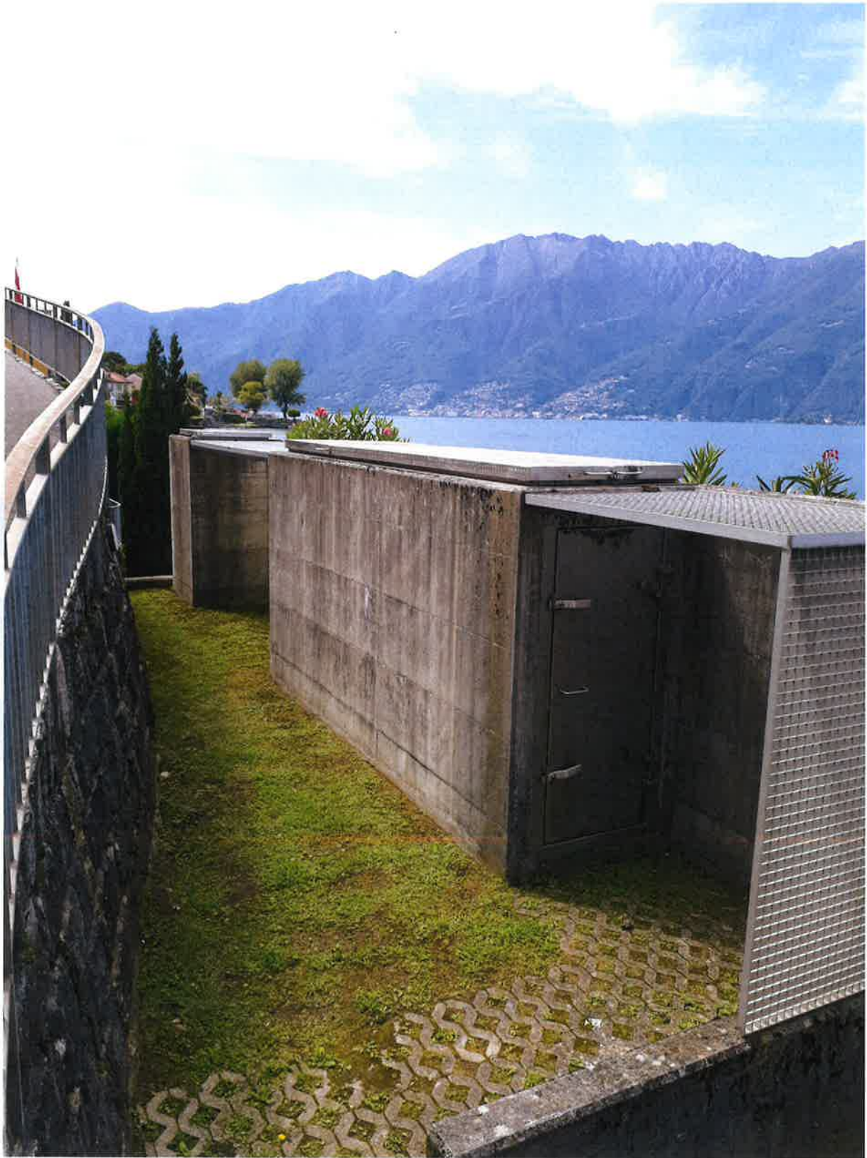
Stazione di pompaggio GSP67
