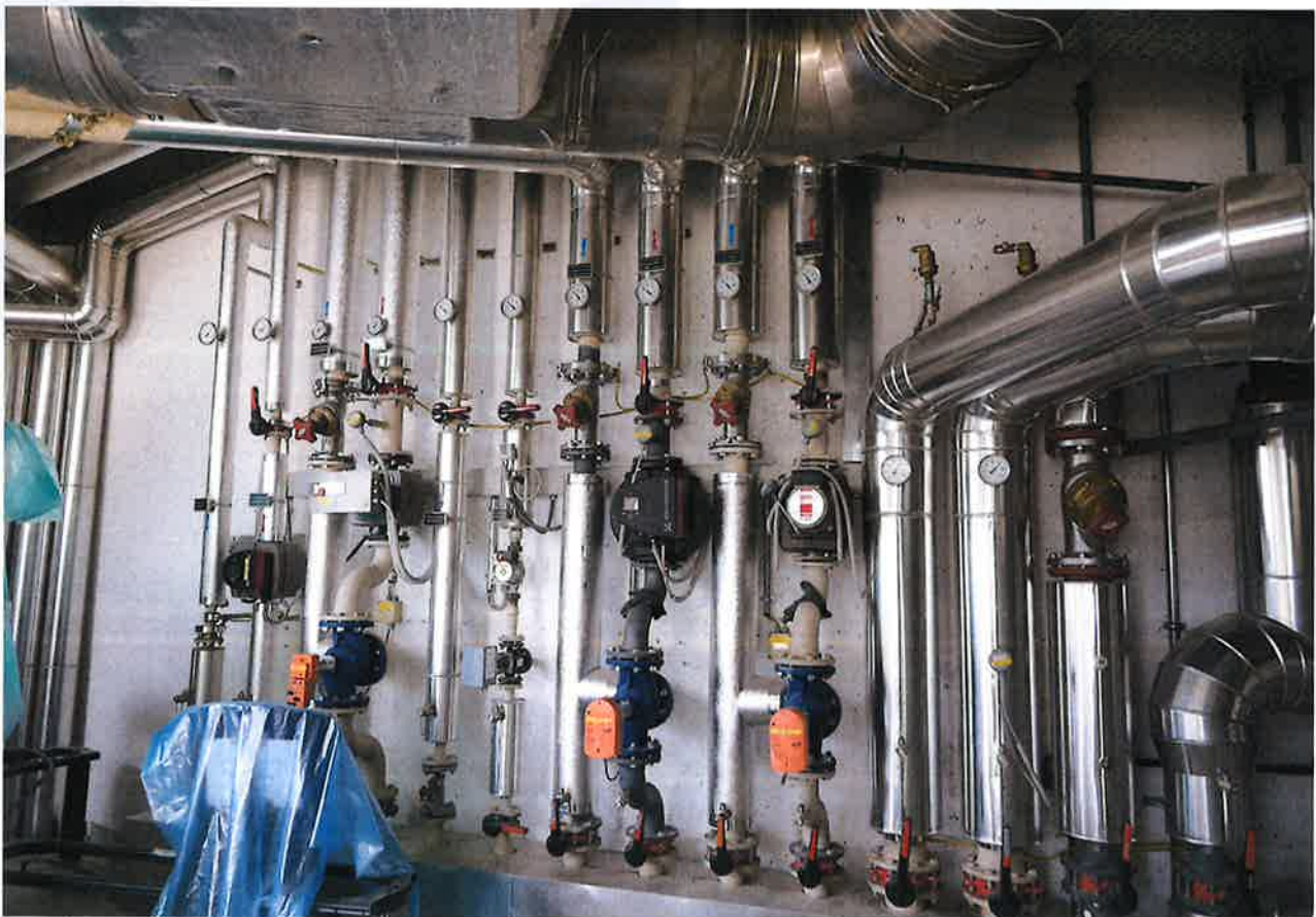
Foce Ticino – locale di futura installazione della nuova caldaia
